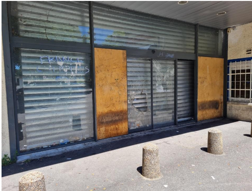
Figure 35 : Photo prise en juillet 2022 présentant les dernières dégradations sur l'accès principal de la galerie (source : EPFNA)
